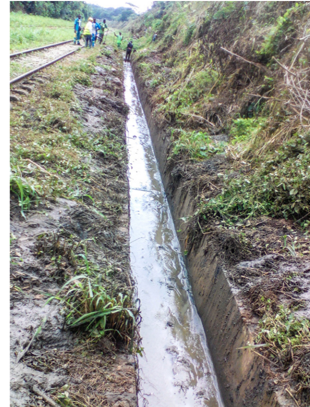
Curage du caniveau en amont de l'avaloir par les ouvriers de la SITARAIL - ©SITARAIL
